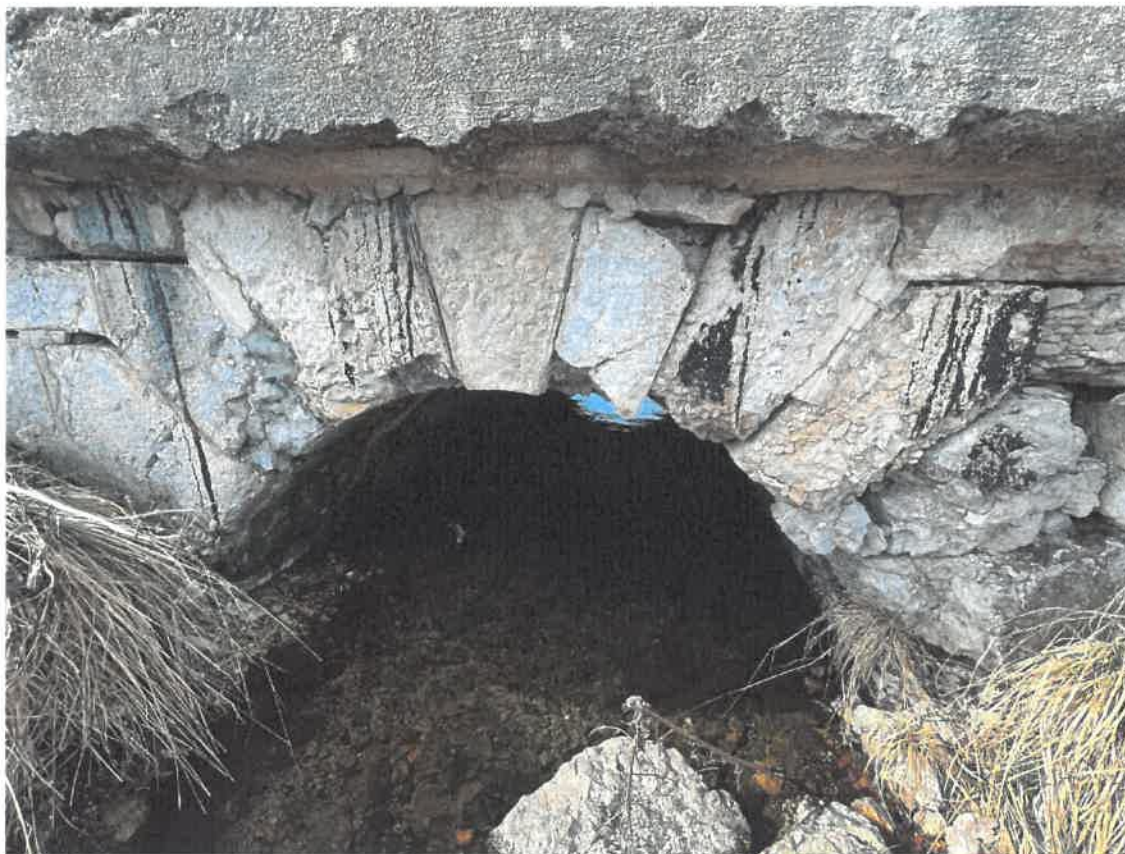
Eclat des pierres gélives du bandeau aval
