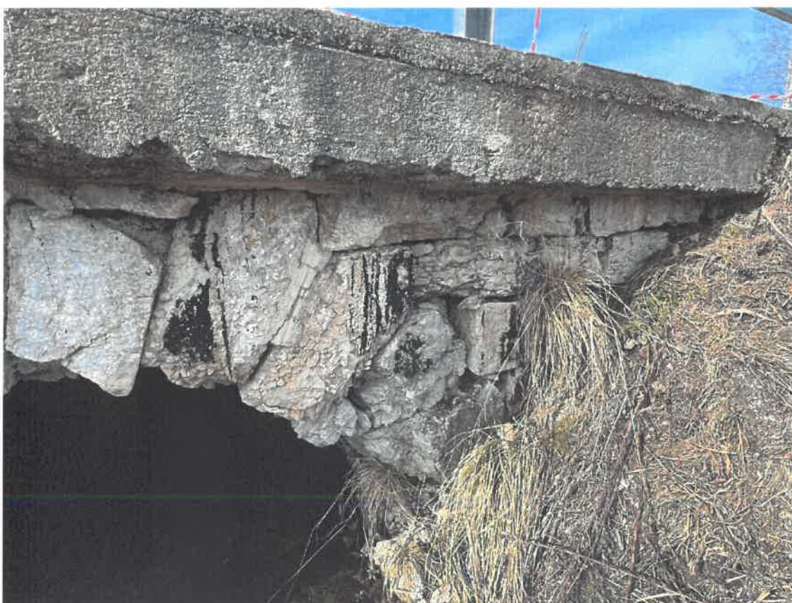
Eclat des pierres gélives du tympan aval rive gauche
