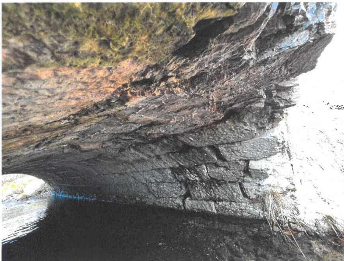
Disjointsioement, décollement du bandeau et affaissement de moellons de la tête aval
