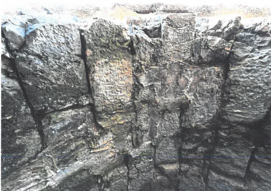
Eclat des pierres du bandeau aval
