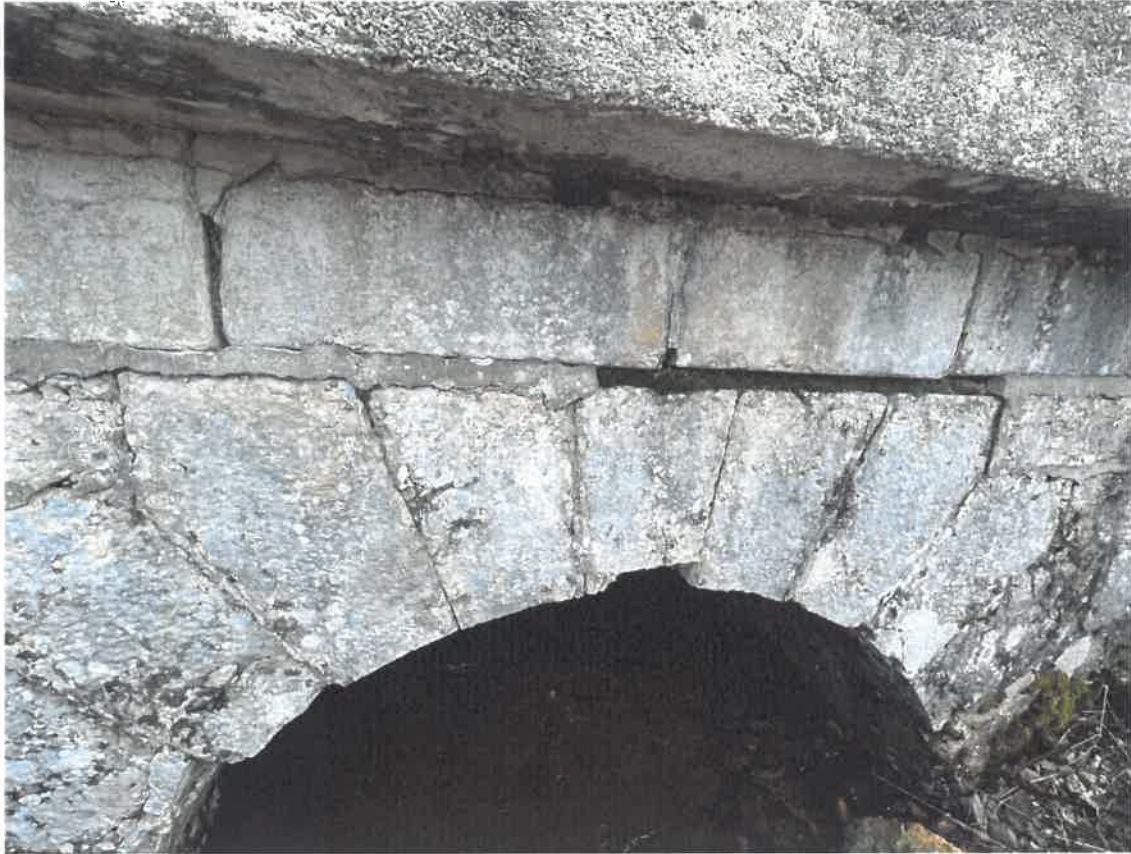
Eclat des pierres gélives du bandeau amont
