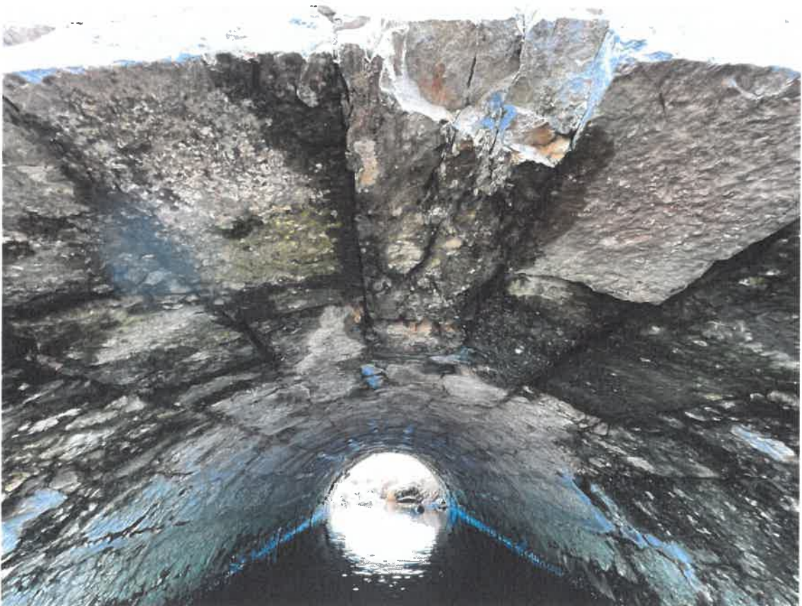
Eclat des pierres gélives et décollement du bandeau amont
