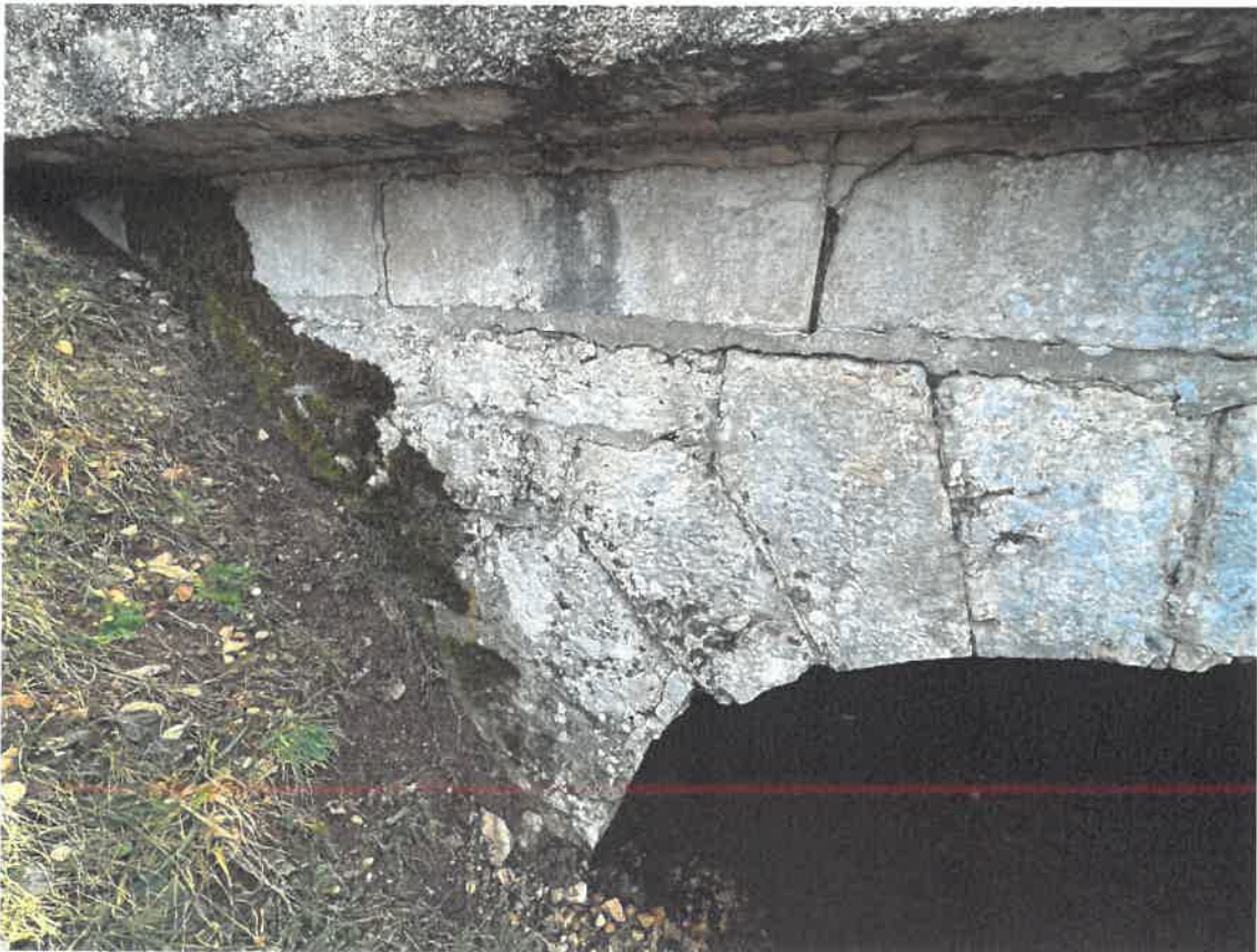
Eclat des pierres gélives du tympan et du bandeau amont / rive gauche
