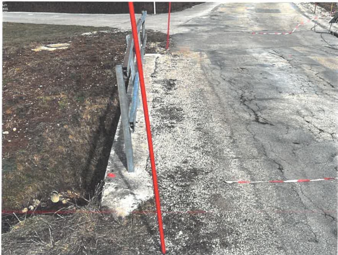
accotement amont depuis la rive droite déformation du garde-corps à la suite d'un choc de véhicule
