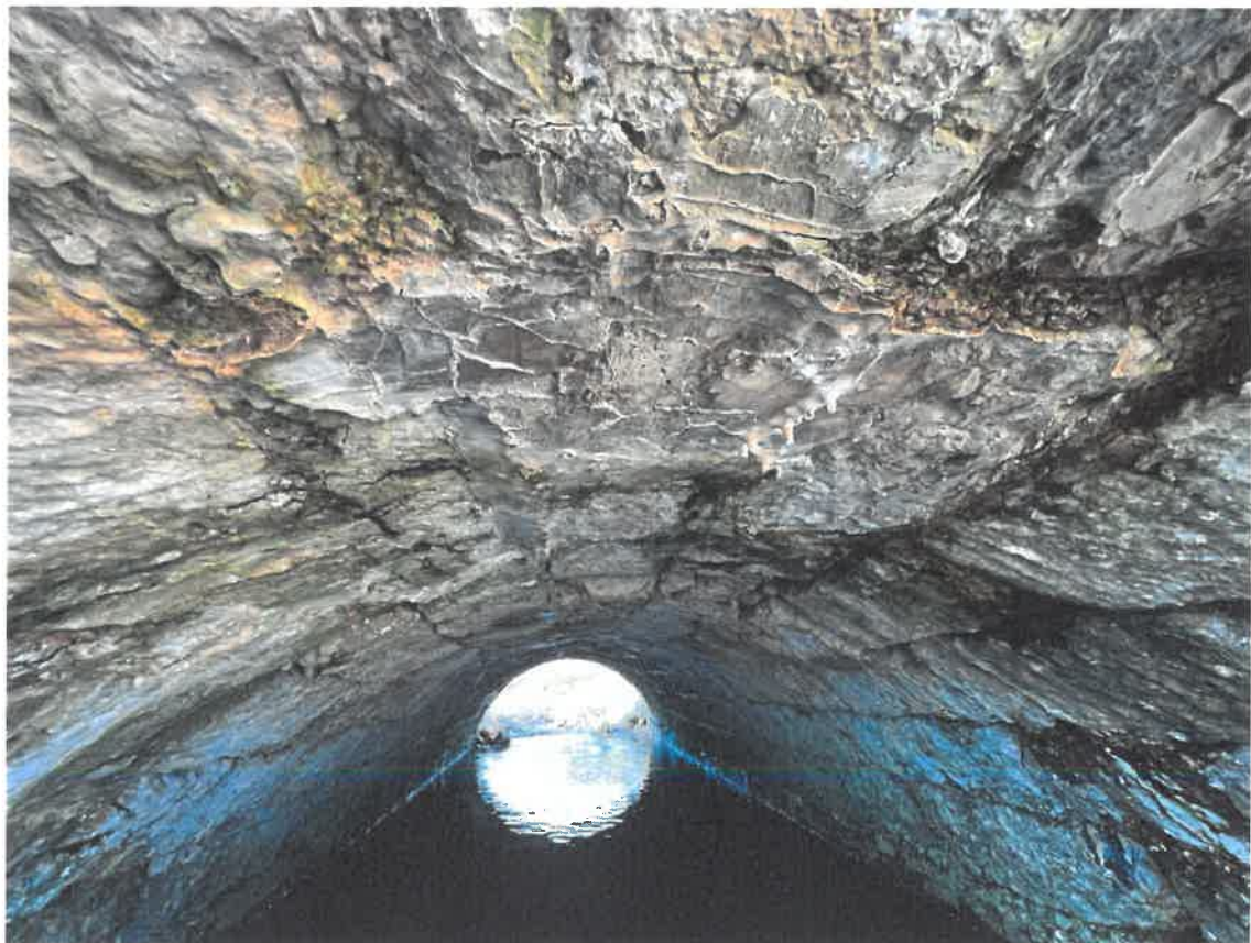
Affaissement de la voûte et descellement es moellons sur 2m de longueur, situé à environ 1.15 m de la tête aval
