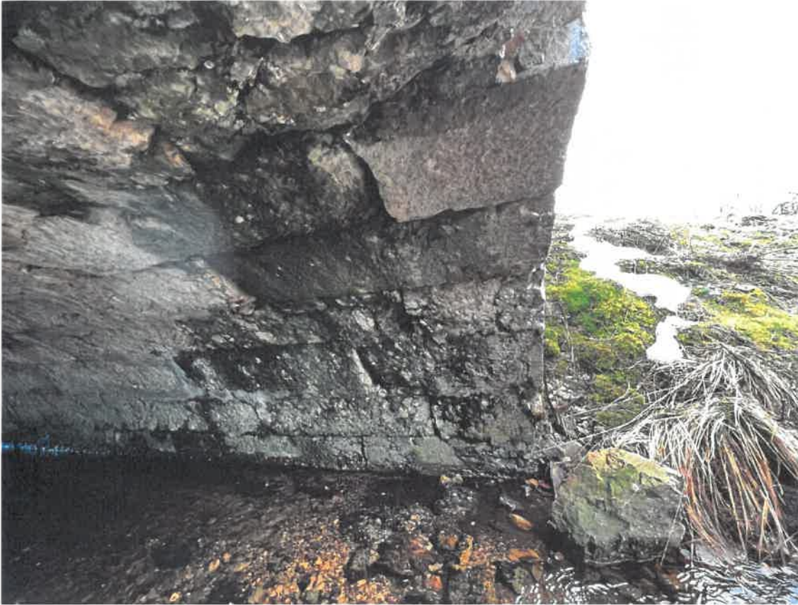
Eclat des pierres gélives et décollement du bandeau amont côté rive droite
