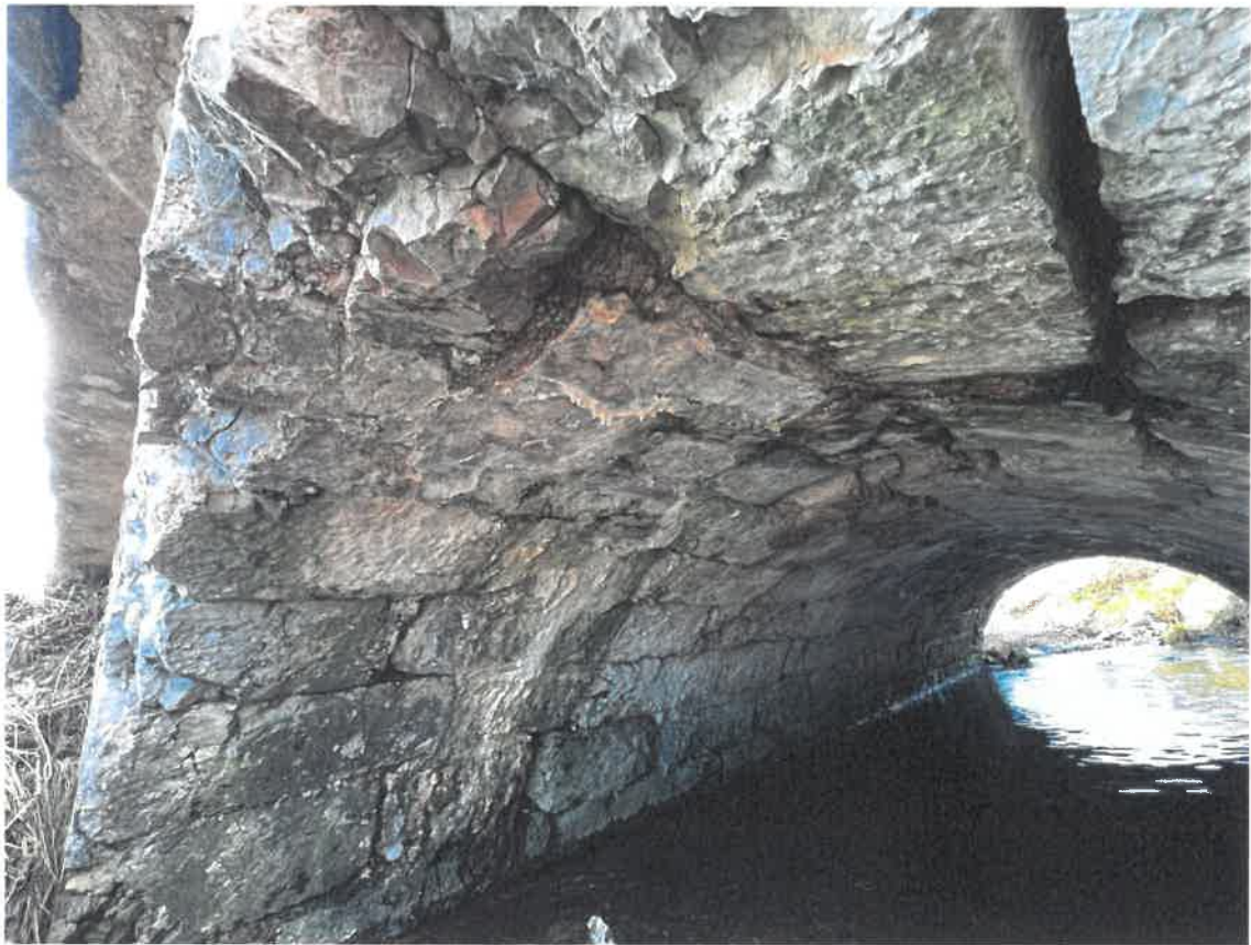
Eclat des pierres gélives du bandeau et de la voûte côté aval rive droite
