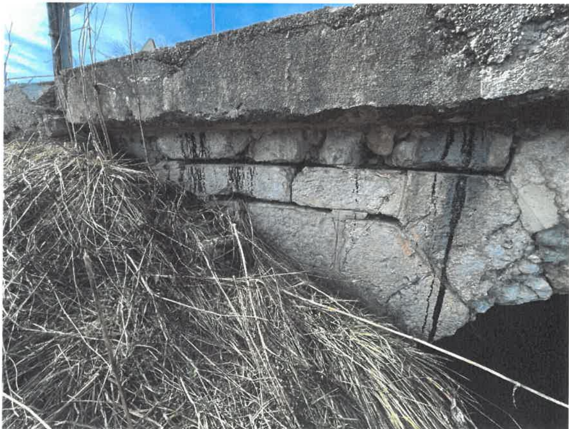
Tympan aval rive droite Disjointoiement / éclat des pierres / éclat et érosion du béton de la longrine
