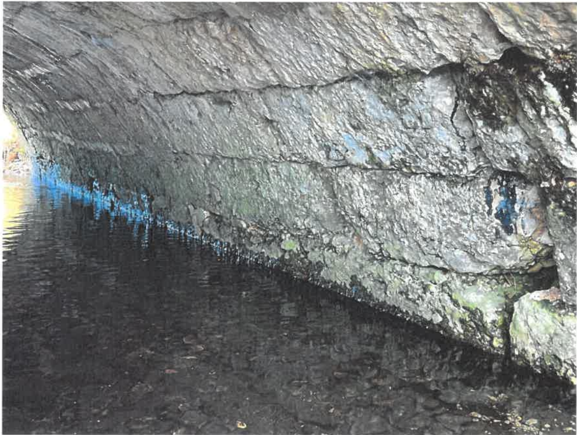
Eclat des pierres en pied de voûte côté rive gauche, dans la zone de marnage
